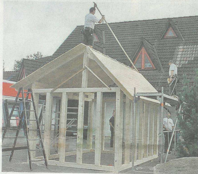
Der Dachdeckerbetrieb Specht baute eine Rasthütte, die auf einem Wanderweg in der Nähe des Wildgeheges aufgestellt werden soll.
